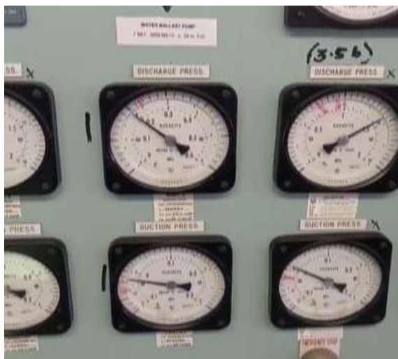
Gambar 1. Tekanan Pompa Rendah
